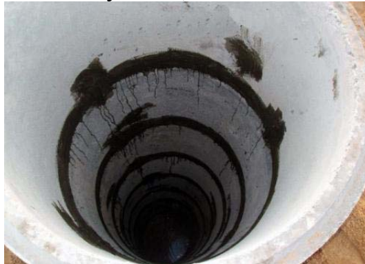
Колодец с внутренней изоляцией
